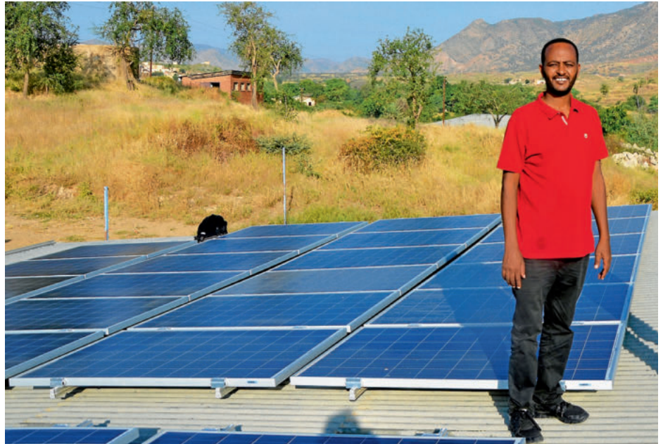
Die Solaranlage liefert rund um die Uhr Strom für die Gehörlosenschule.
